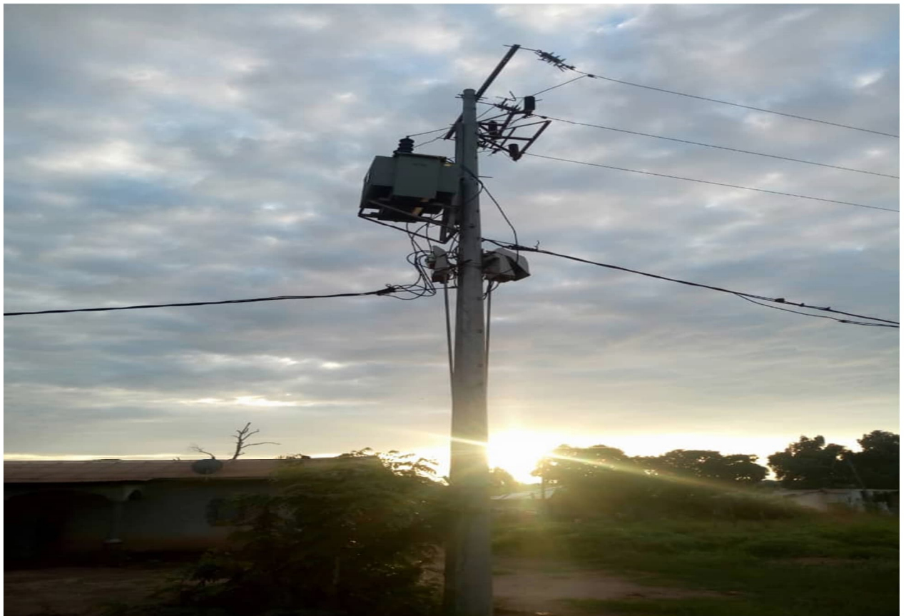
Photo 15 : Ligne monophasée au centre urbain
